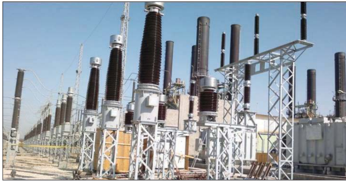
شبكة توزيع كهرباء
