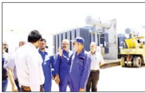
محطة كهرباء الشهداء في ميسان
