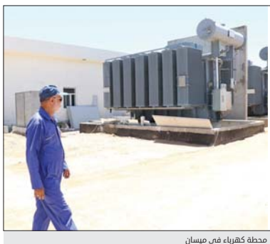
محطة كهرباء في ميسان
