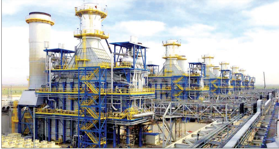
محطة لإنتاج الطاقة الكهربائية في العراق
