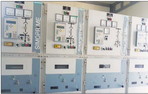
وحدة سيطرة المحطة التحويلية في النجف
