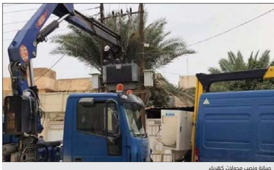
صيانة وتصب محولات كهرباء
