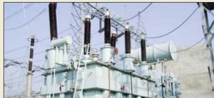
محطة تحويل الطاقة الكهربائية للساموكين
