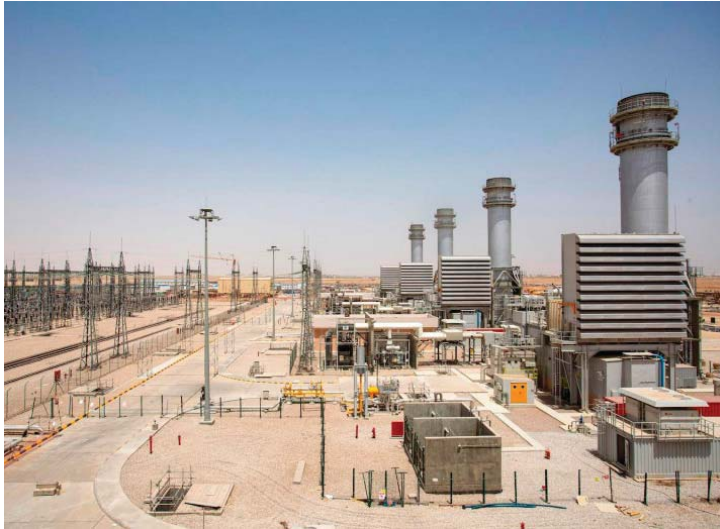
● محطة كهرباء في مدينة السماوة جنوب العراق
