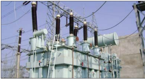
محطة تحويل الطاقة الكهربائية في واسط
