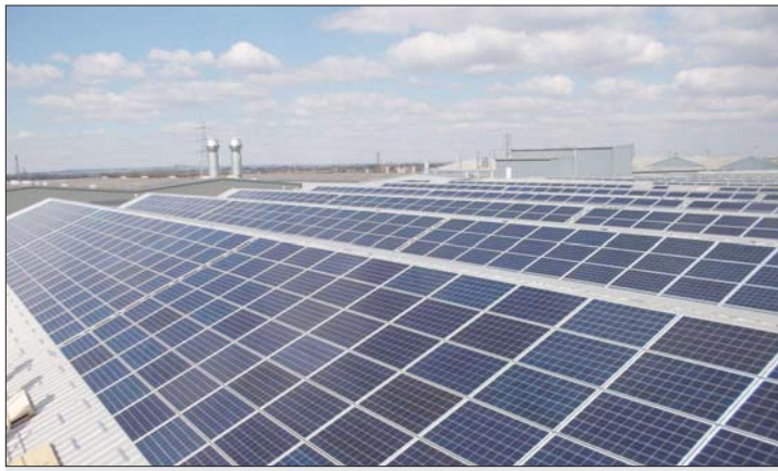
وحدات لتوليد الطاقة الشمسية الى كهرباء
