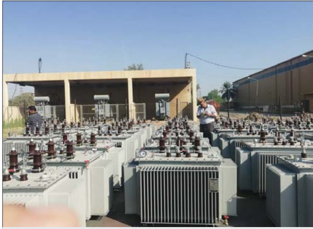
إنتاج محولات الكهرباء في شركة بوابي
