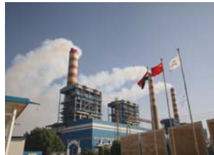
● صورة التقطت في 16 ديسمبر / كانون الأول 2020 تظهر محطة وسط الطاقة الحرارية التي تبنيها وتنفذها مجموعة شنتشي للكهرباء، في محافظة وسط جنوب العراق.
