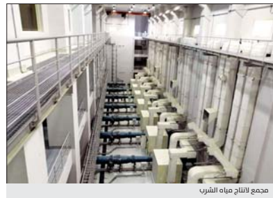
مجمع لانتاج مياه الشرب
