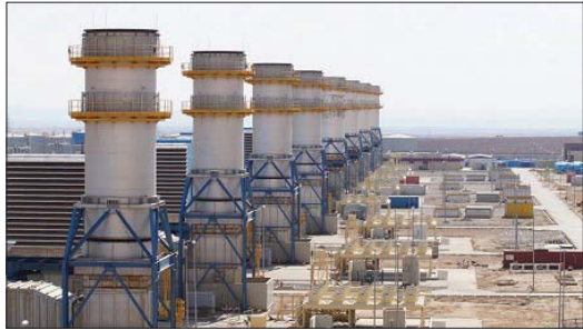
● محطة كهرباء - أريشيف
